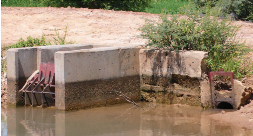
Illustration 6: Adduction d'une vanne guillotine à une vanne à masque par manque de niveau d'eau en bout du partiteur MD 2
